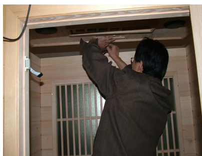
Obr.-13 Vedení kabelů ohřivačů na panelech prostřednictvím příslušného otvoru
